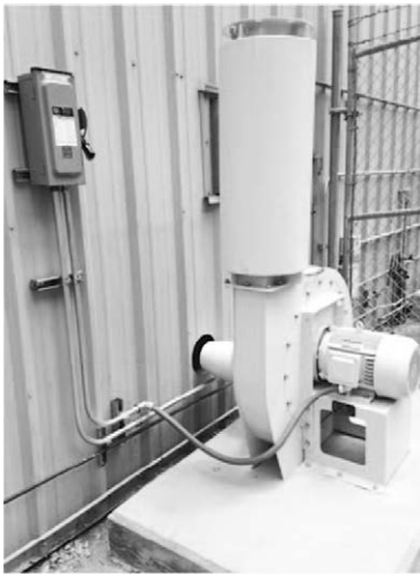
Вентилятор, расположенный снаружи
