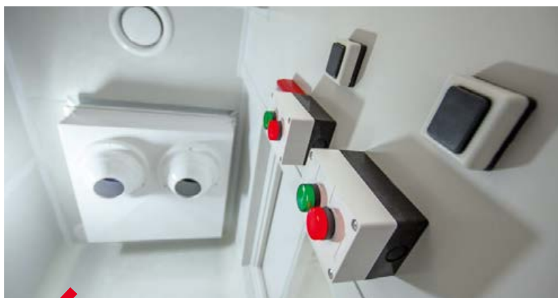
Тамбур-шлюз для обдува персонала чистым воздухом. Обдув осуществляется с перепадом давления в несколько Паскалей.
