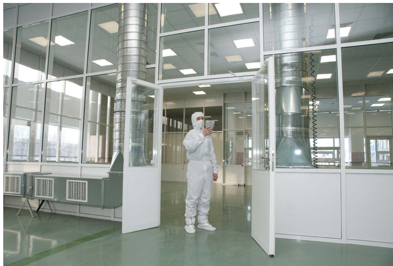
Чистые помещения, оборудованные компанией «Диполь» на предприятии заказчика
